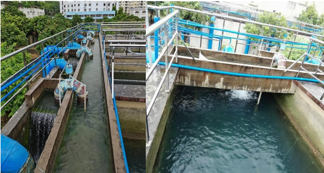
图 4.7-3 一期虹吸滤池现场照片
