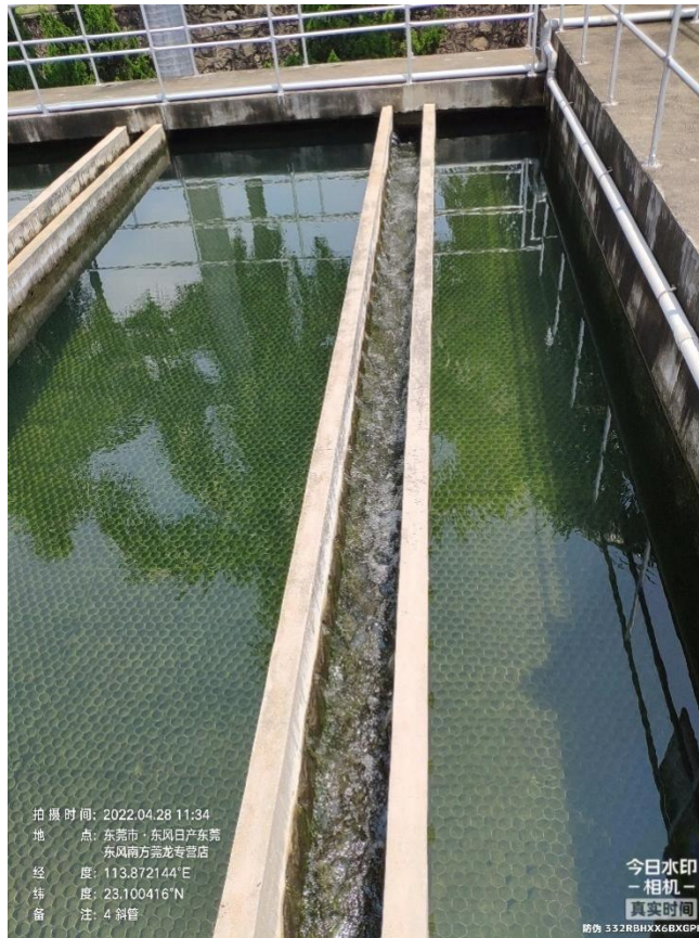
图 3.5-3 西湖水厂斜管沉淀池
