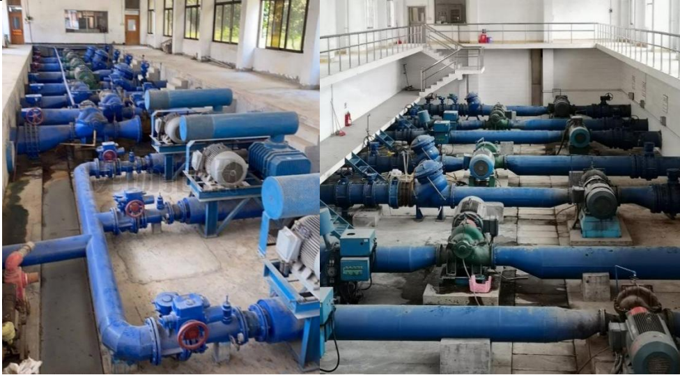
图 4.7-1 一期、二期二级泵房
