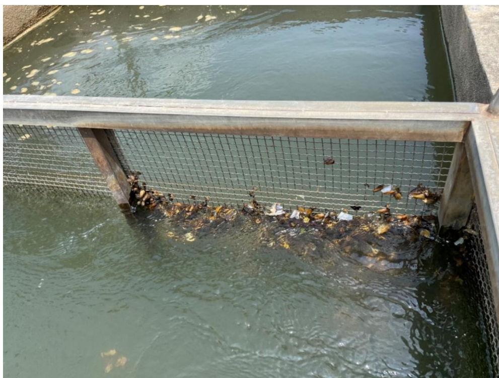
图 3.3-2 石碣水厂网格絮凝池
