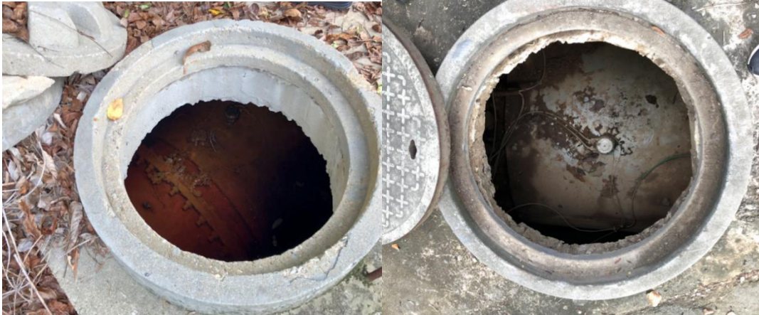
图 3.7-6 二期进出水流量计均已损坏
