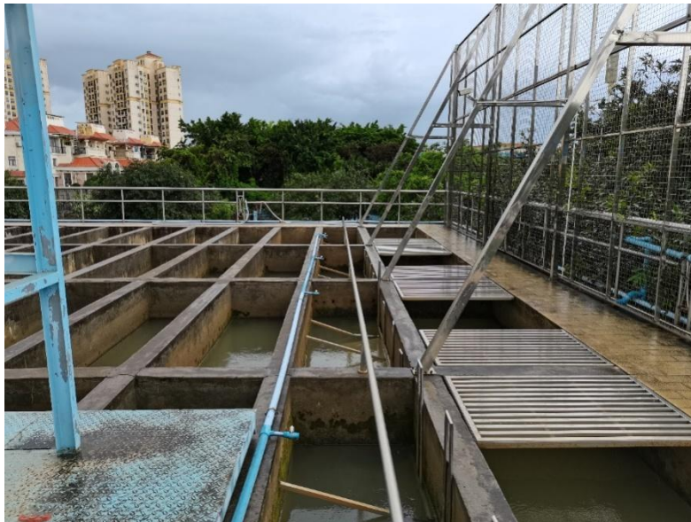
图 4.7-2 二期网格絮凝池
