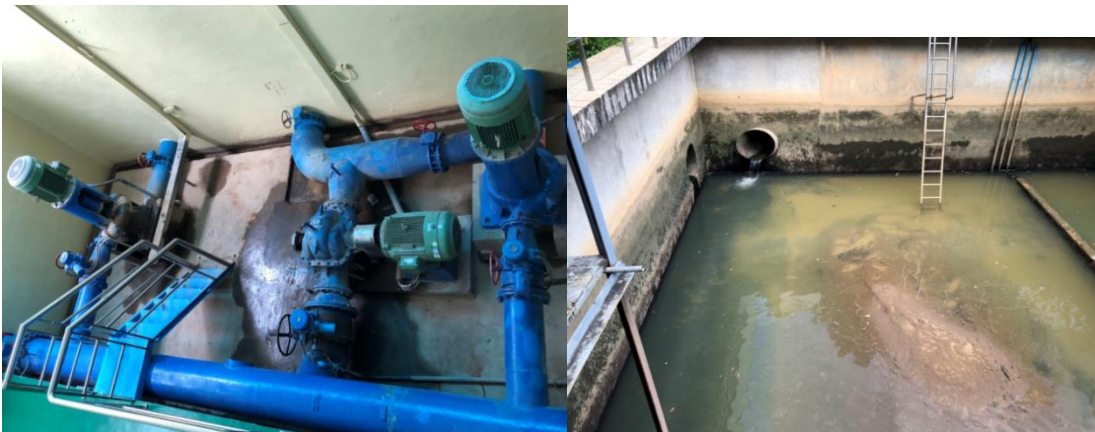
图 3.7-7 回用水系统提升泵房及集水池
