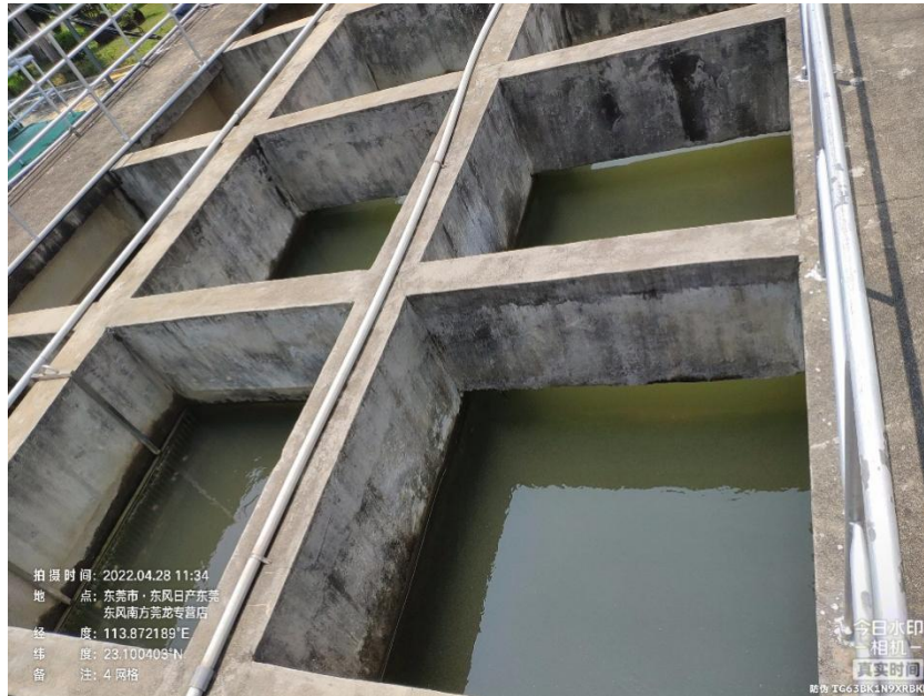
图 3.5-2 西湖水厂网格絮凝池
