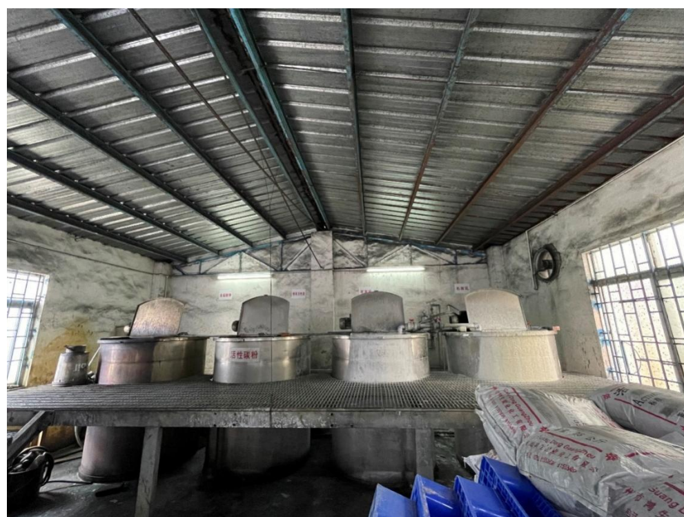
图 3.3-3 石碣水厂现状加药间
