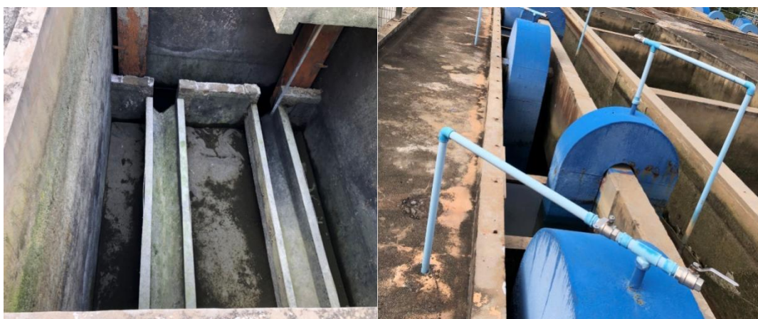
图 3.7-3 一期虹吸滤池
