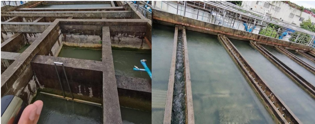
图 3.8-2 一期网格絮凝池、斜管沉淀池
